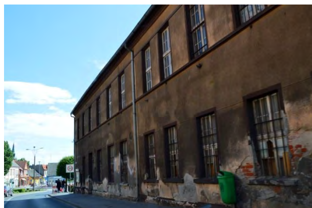
Fot. 187. Zniszczona zabudowa w starej części miasta (fot. P. Rutkowski)
