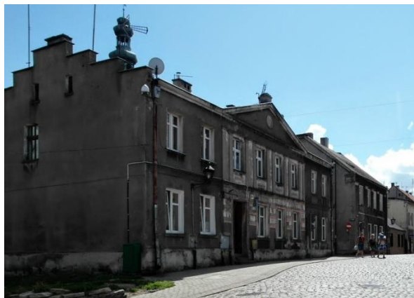
Fot. 170. Zniszczone budynki mieszkalne przy ulicy Chelmińskiej i Generała Józefa Hallera (fot. P. Rutkowski)
