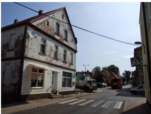
Fot. 183. Kamienica wymagająca remontu przy ul. Bydgoskiej (fot. P. Rutkowski)
