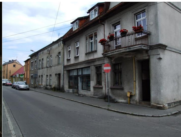
Fot. 191. Kamienice wymagające remontu (fot. P. Rutkowski)
